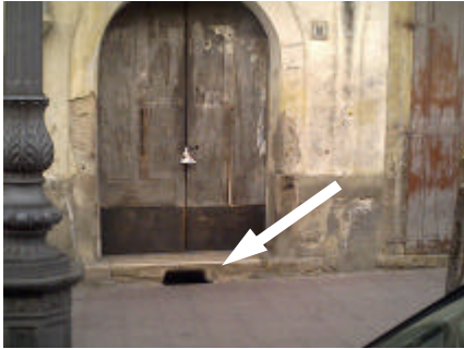
La presa d'aria della cantina
